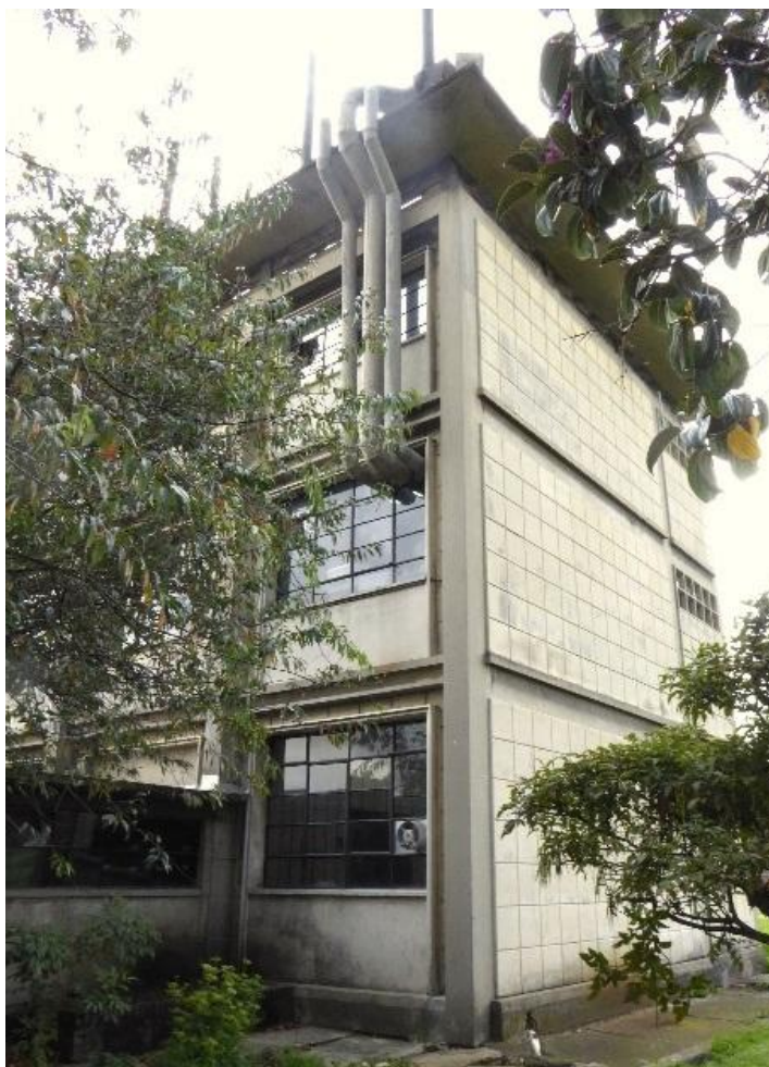
Ilustración 71. Tuberías y salientes adosadas al edificio agresivamente. Foto: CNM
